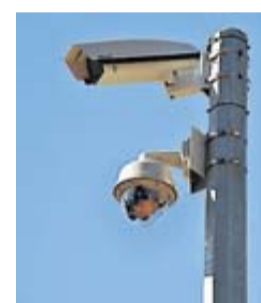
Les caméras servent aussi pour la verbalisation. / DDM
