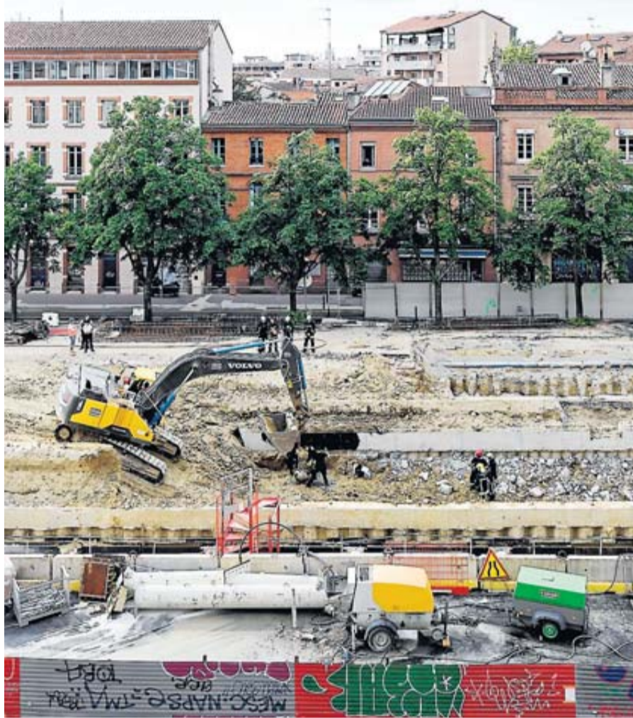
Le chantier des allées Jean-Jaurès, l'un des points noirs du centre-ville. / DDM, Xavier de Fenoyl
